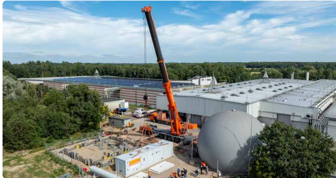
Der 1-MW-Elektrolyseur für die Stadtreinigung wurde Ende 2024 angeliefert und wurde im Oktober 2025 in Betrieb genommen.
